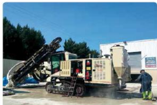
■ Aire étanche de ravitaillement, d'entretien et de nettoyage reliée à un décanteur-déshuileur
